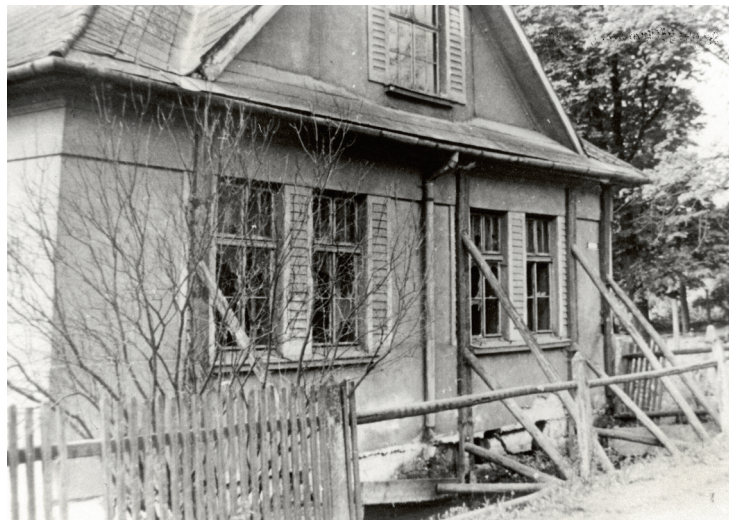
Poddolovaný dům s poškozeným základovým zdívem a podpěrami proti zborcení vychýlených zdí. Stejným způsobem se uvnitř domů podpíral také nábytek, kterému na nakloněné podlaze hrozilo převržení. Fotografie ze sbírek Státního okresního archivu Karviná
