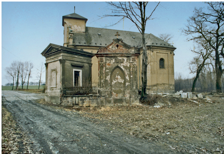
Kostel svatého Petra z Alkantary v roce 1993, vlivem poddolování zničený, propadlý o víc než třicet metrů a vychýlený o 6,8 stupně, tedy mnohem více než šikmá věž v Pise. V této době vrcholilo úsilí faráře Ernesta Dostala o jeho záchranu. Kostel byl v následujících dvou letech opraven firmou Forti za použití unikátní metody; opravu financovaly Důl Darkov a Důl ČSA. Fotografie ze sbírek Státního okresního archivu Karviná
